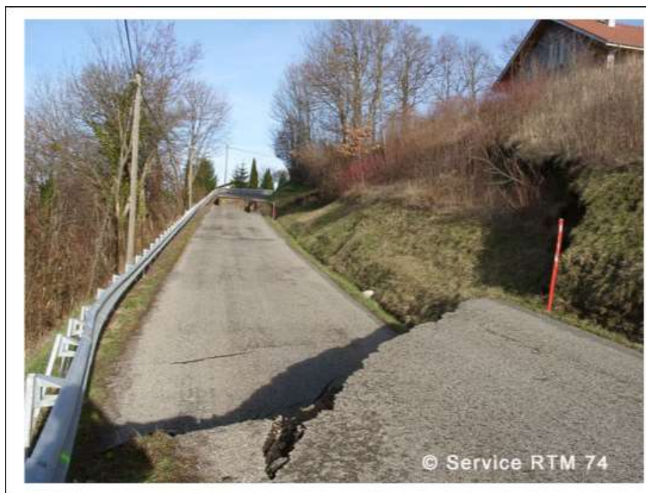
Glissement de terrain Féternes 2001
